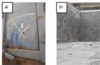
Rys. 2. a) Dziura w drzwiach wyładowniczych węglarki; b) Widok węglarki od środka
