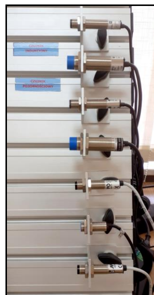
Rys. 4. Czujniki zamontowane na płycie montażowej (opracowanie własne)
